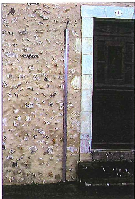
Cable apparent très inesthétique sur une façade
