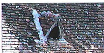
Houteau triangulaire sur un toit en tuile plate
