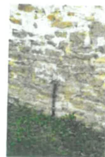
point d'eau du logement à l'extérieur
