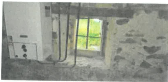
chaudière au gaz de ville hors d'usage
