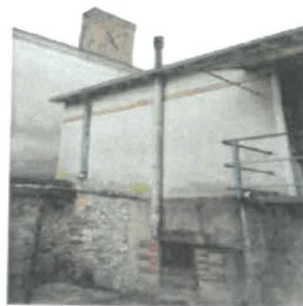
descente d'eau pluviale non raccordée
