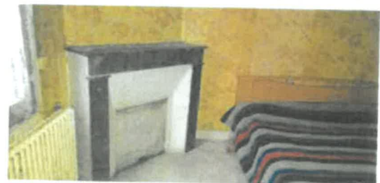
Chambre, ancienne cheminée inutilisée instable
