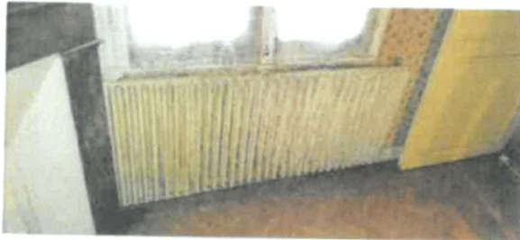
radiateur en fonte / chaudière hors d'usage
